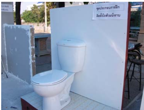
ภาพที่ 3-39 ฝึกปฏิบัติการติดตั้งสุขภัณฑ์
