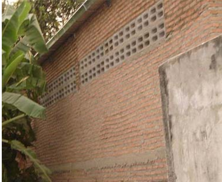
รูปที่ 2 การก่อผนังไม่ถูกต้อง (ไม่มีเสาเอ็น) (ที่มา :www.selectcon.com)
