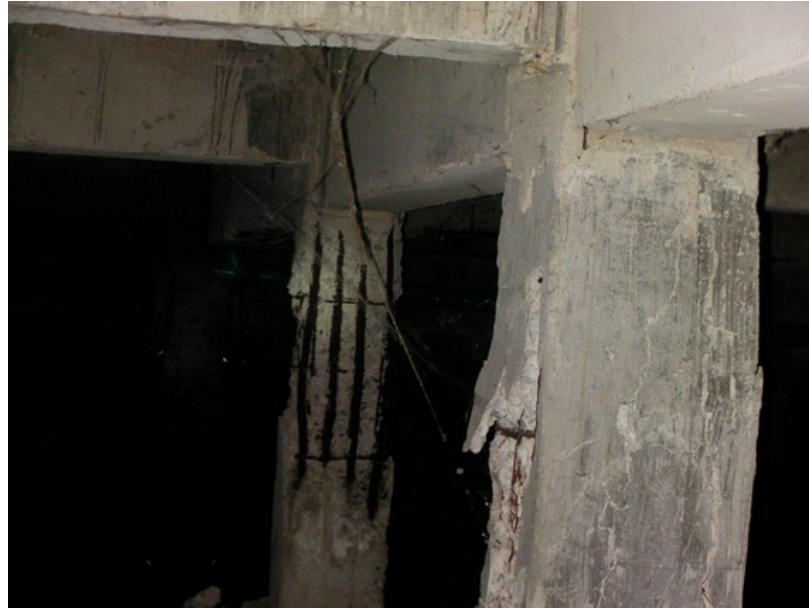
รูปที่ 4 ลักษณะการวิบัติที่เกิดขึ้น
